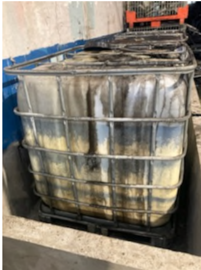
Cuves de stockage des fluides vidangés stockés sur rétention maçonnée
